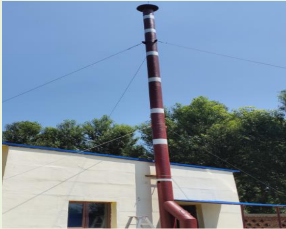
15m 高排气筒
