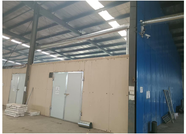
白膜烘干管道 1
