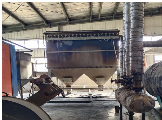
锅炉布袋除尘器
