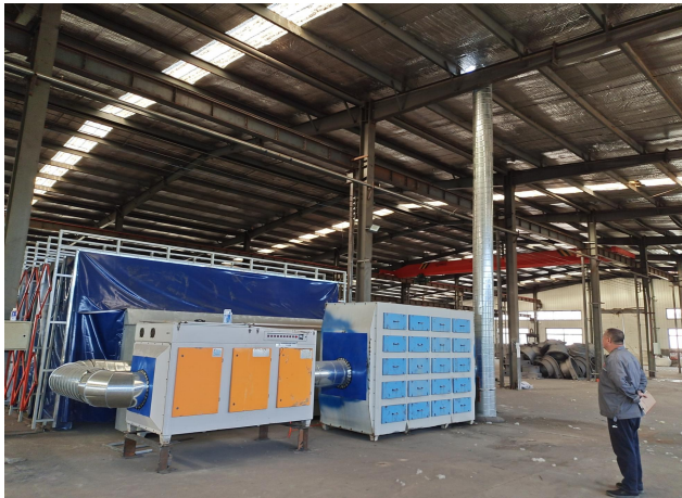
UV 光氧+活性炭吸附装置+ 15m 高排气筒 (7#)
