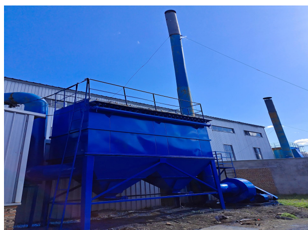
电炉熔炼布袋除尘器+18m 高排气筒 (1#)
