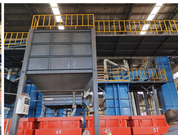
消失模铸造线造型、砂处理设备密闭 2
