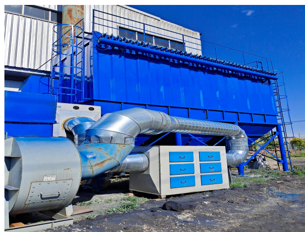
呋喃树脂砂浇铸+消失模真空负压浇筑 工序布袋除尘器+UV 光氧+ 活性炭吸附装置
