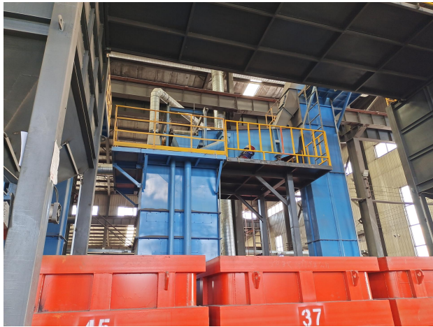
消失模铸造线造型、砂处理收集管道 2
