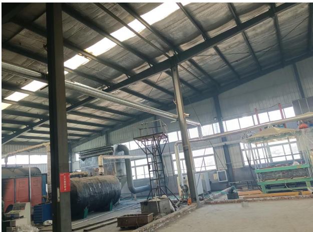
白膜烘干管道 2
