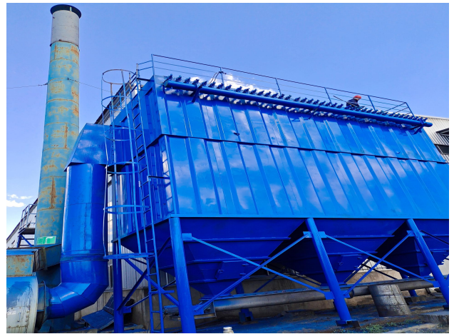
消失模铸造线造型、砂处理布袋除尘器 +18m 高排气筒 (3#) (呖喃树脂砂造型、砂处理工序依托)
