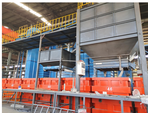
消失模铸造线造型、砂处理设备密闭 1
