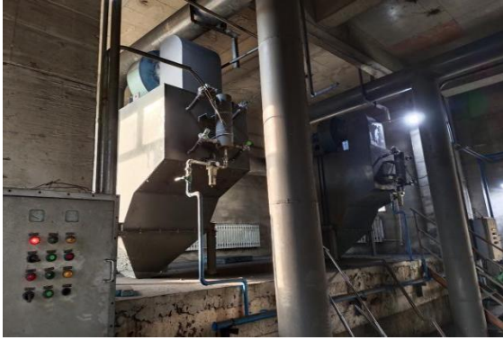
破碎楼布袋除尘器
