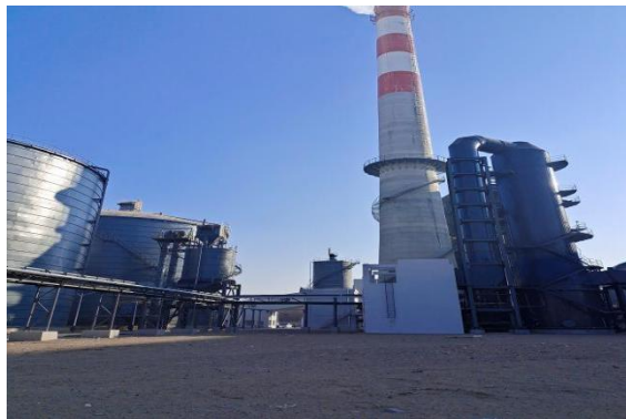
石灰石粉仓布袋除尘器+25m 排气筒 (DA007)
