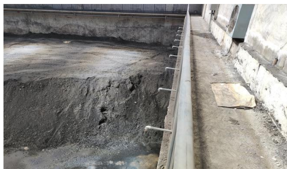
封闭干煤棚内手动喷淋系统
