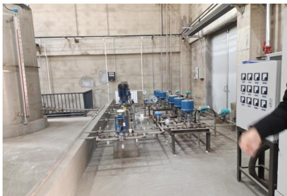
锅炉脱硝系统
