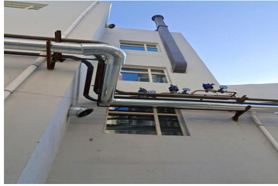
破碎楼 19.7m 排气筒 (DA002)
