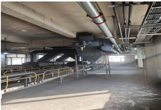
输煤转运站集气罩+布袋除尘器
