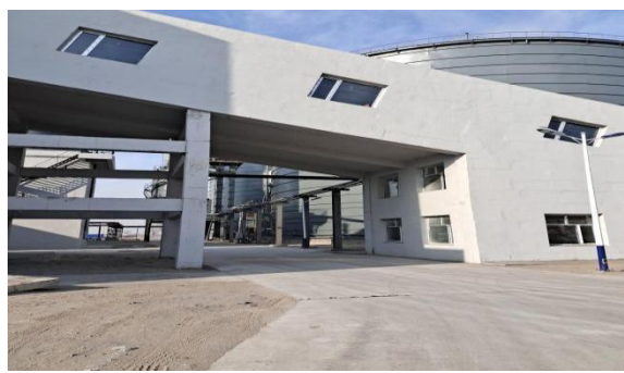
干灰封闭气力运输管道
