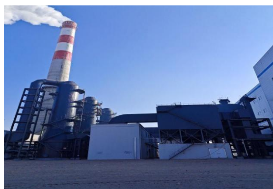
锅炉布袋除尘器+脱硫塔+100m 烟囱 (DA001)
