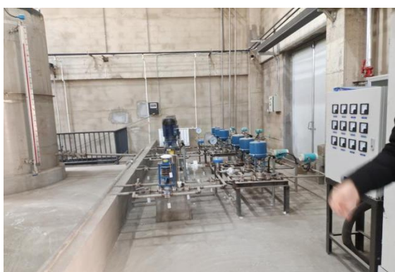
锅炉脱硝系统
