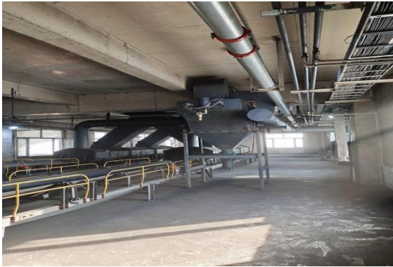
输煤转运站集气罩+布袋除尘器
