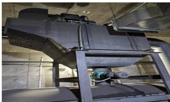
输煤栈桥布袋除尘器
