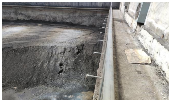
封闭干煤棚内手动喷淋系统
