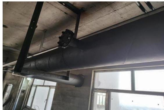
输煤转运站 30.2m 排气筒 (DA003)
