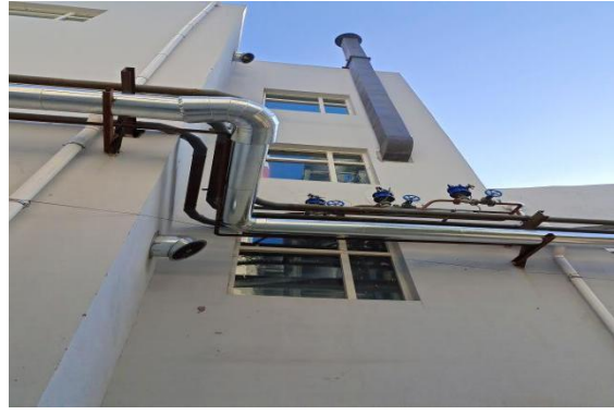
破碎楼 19.7m 排气筒 (DA002)
