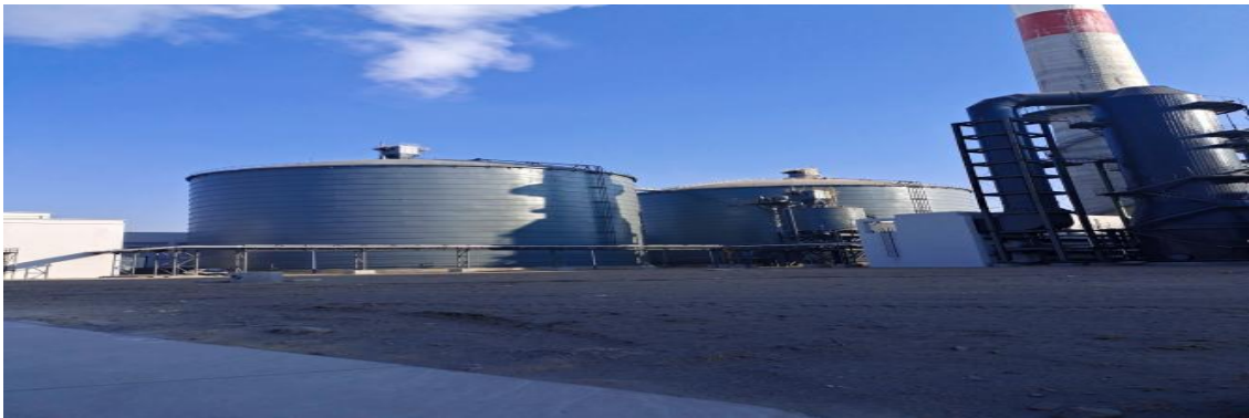
从左到右依次为封闭灰库（西）布袋除尘器+41m 排气筒 (DA004)、封闭灰库（南）布袋除尘器+23m 排气筒 (DA008)、封闭灰库（东）布袋除尘器+41m 排气筒 (DA005)
